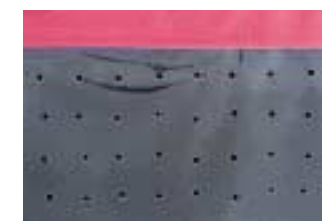
・多孔天井フィルム部
