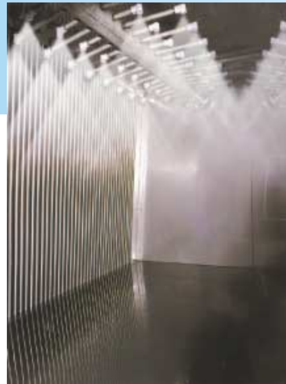
・空調機内部
