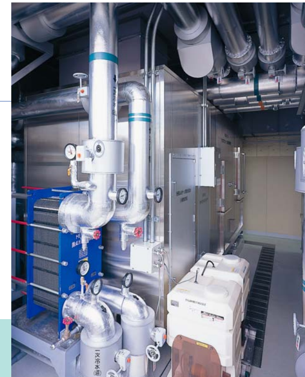
・空調機と機廻り設備機器
