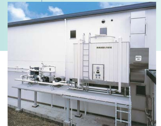
・脱臭装置 & 冷却塔
