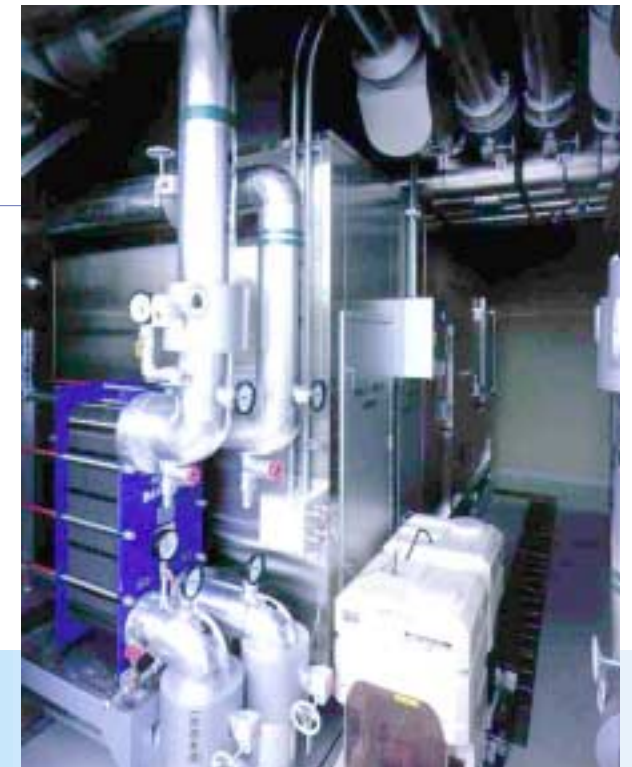
・空調と機回り設備機器
